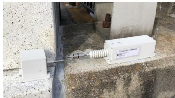
試験設置しているセンサー
